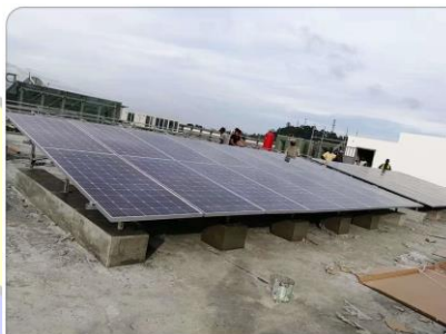
Installazione a terra
